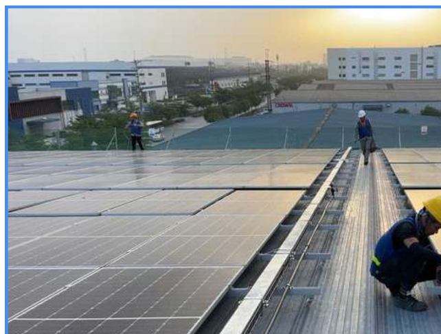
DỰ ÁN NEWWING 2, BẮC GIANG CÔNG SUẤT: 10 MWP
