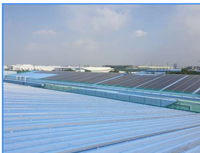
DỰ ÁN GIÀY NGỌC TỀ, HƯNG YÊN CÔNG SUẤT: 4,6 MWP
