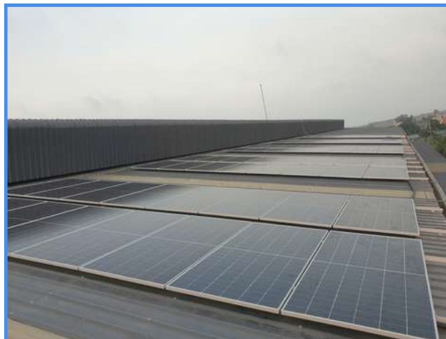
DỰ ÁN MÁY QUẢNG HỢP, THANH HÓA CÔNG SUẤT: 50 KWP
