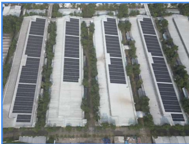
DỰ ÁN MAY ALENA YÊN ĐỊNH, THANH HÓA CÔNG SUẤT: 2 MWP
