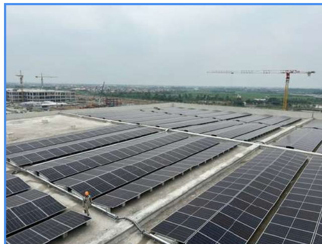
DỰ ÁN COT, HƯNG YÊN CÔNG SUẤT: 2,1 MWP
