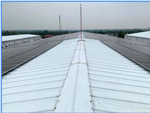
DỰ ÁN CÔNG TY TNHH CREATIVE LIGHTS VIỆT NAM HD, HẢI DƯƠNG CÔNG SUẤT: 507 KWP
