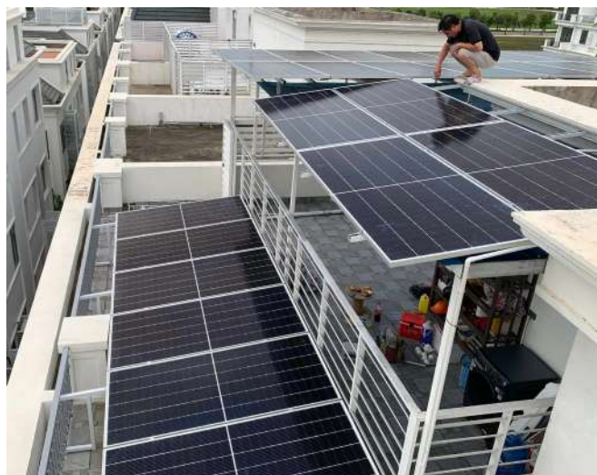
CÔNG TRÌNH BIỆT THỰ VINHOME CÔNG SUẤT: 13,5 KWP
