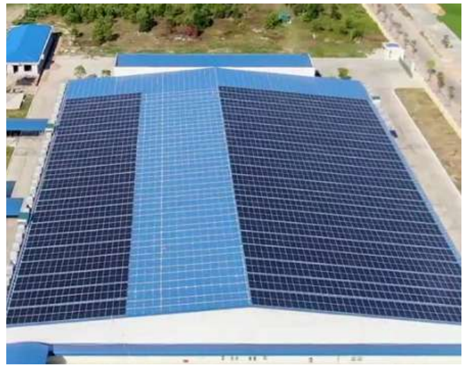
DỰ ÁN NGHĨA HÀNH, QUẢNG NGÃI CÔNG SUẤT: 1 MWP
