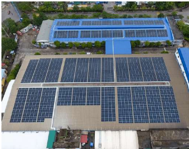
DỰ ÁN DAMSƠN THÁI BÌNH CÔNG SUẤT: 1,2 MWP
